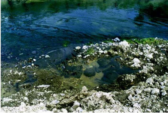
Abb. 9: Aussandungen im Hintergraben während dem Hochwasser 1999. Stetige und über einen längeren Zeitraum stattfindende Aussandungen können aufgrund der inneren Erosion auch zu einem statischen Grundbruch führen (Hohlraum unter Damm).
