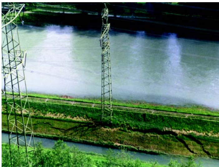
Abb. 8: Grundbrucherscheinungen mit Böschungsfussrutschungen am Linthkanal, Hochwasser 1999: Szenario für obige Überflutungsmodellierung.
