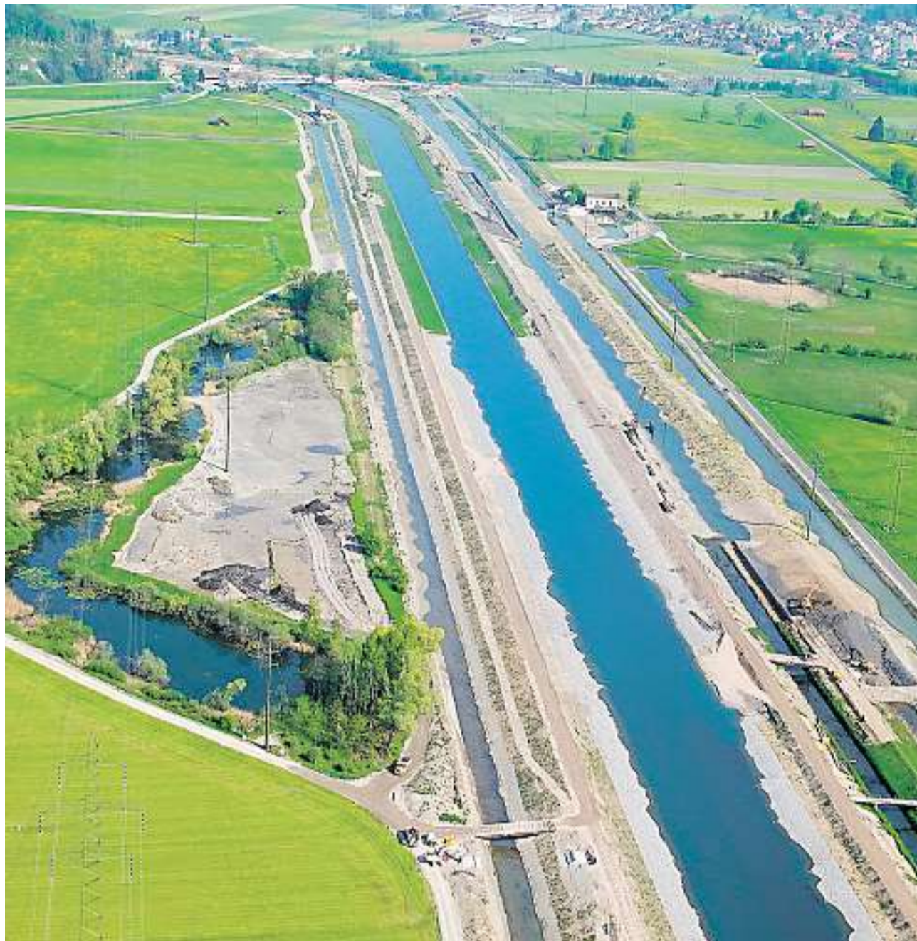
Luftbild in Blickrichtung Grynau. Längs des Linthkanals werden die Dämme saniert und neue, naturnahe Flachufer gebaut. Links im Bild das Elmersee in Benken: Hier wird dank der Sanierung die Rietfläche vergrössert, was den Amphibien zugutekommt. Bild: zvg
