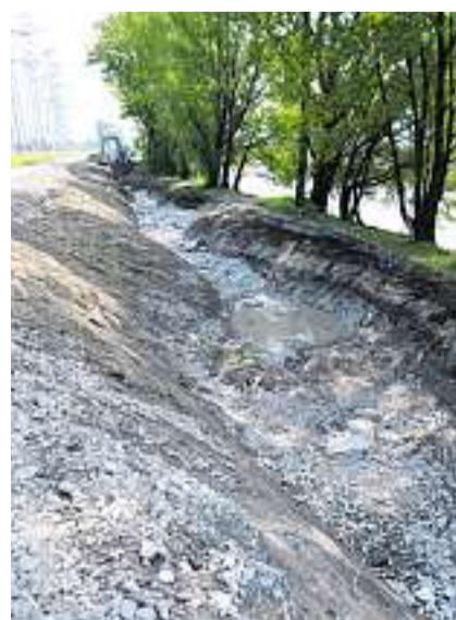
Ausweitung: In Weesen darf die Linth über das Ufer treten.
